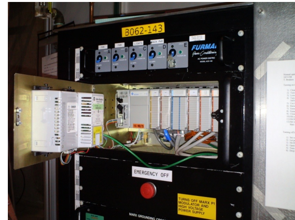
ILC-Marx PLC chassis
